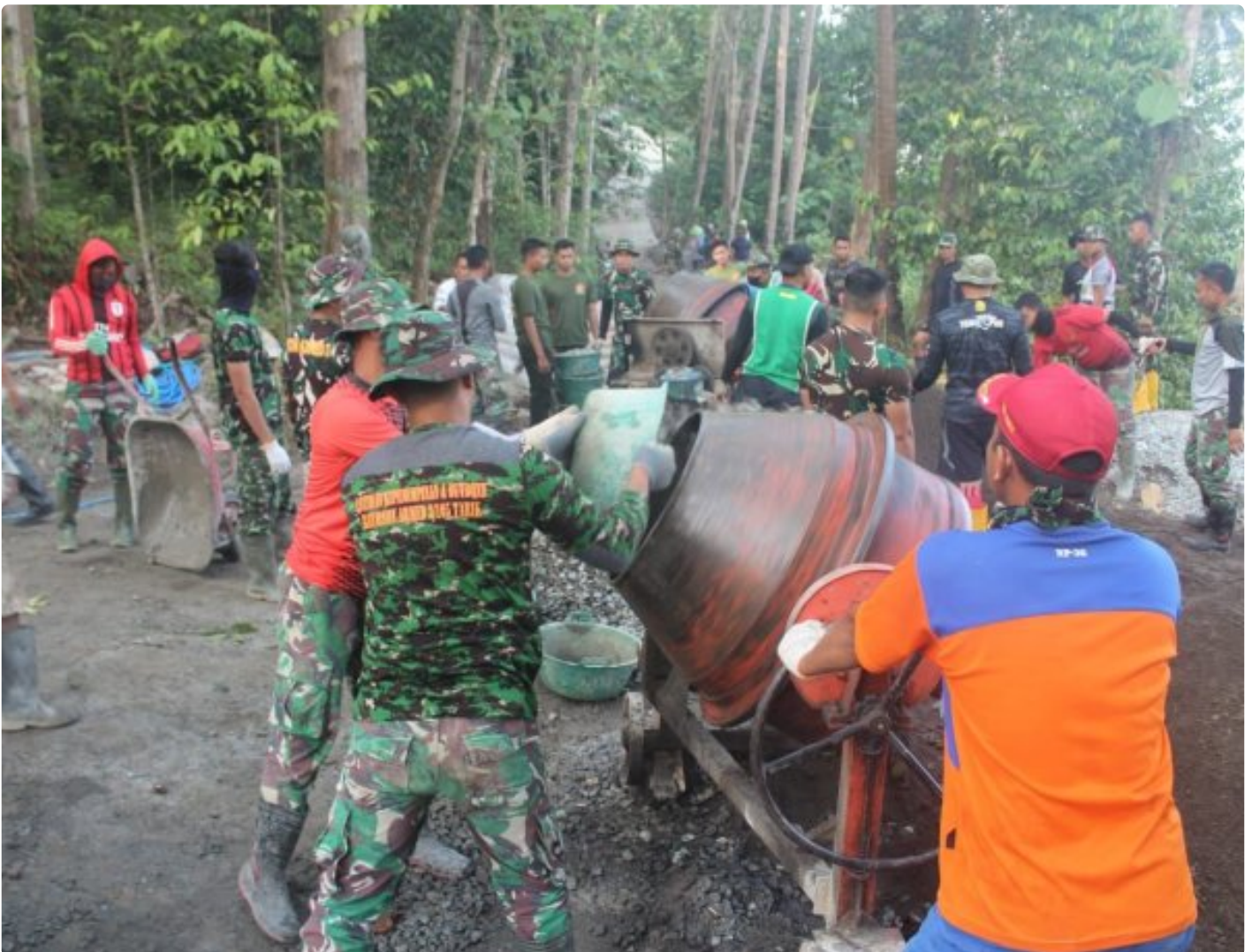
Satgas TMMD Reguler Ke-116 Kodim 0709/Kebumen Bersama Warga terus Pacu Pembangunan Rabat Beton
